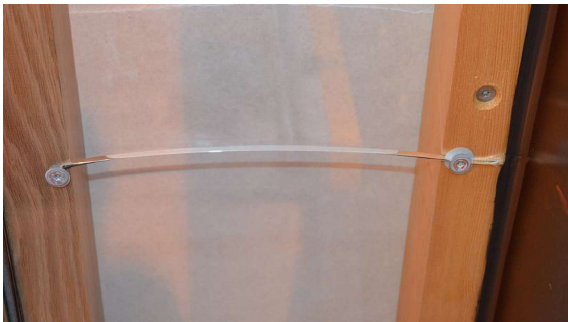
Bild 22. Väg 2, spricka 7, uppstod mellan vattenbegjutningarna.
