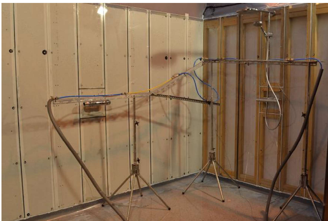
Bild 4. Provuppställning med monterade vattendysor.
