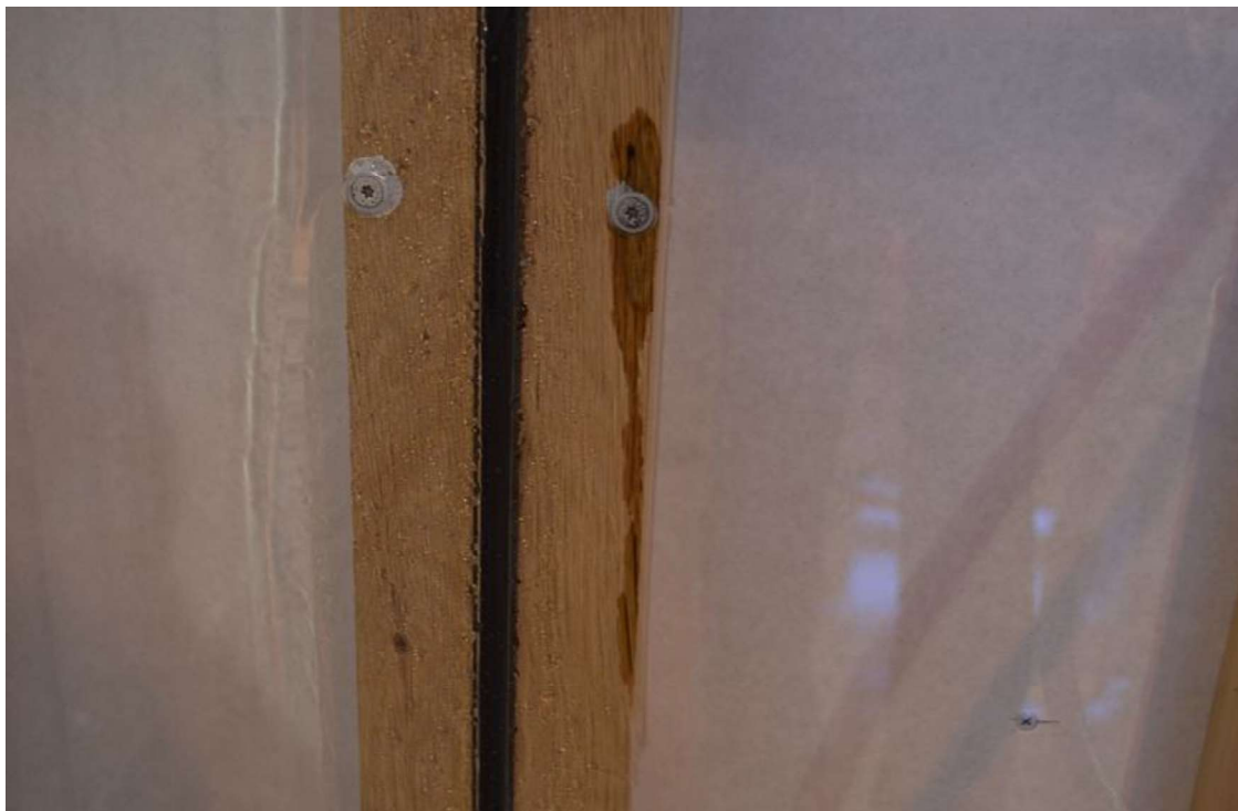
Bild 17. Väg 2, läckage vid skruv.
