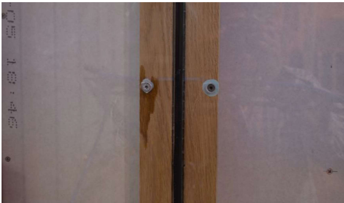
Bild 18. Väg 2, läckage vid skruv på bytt glaspanel.
