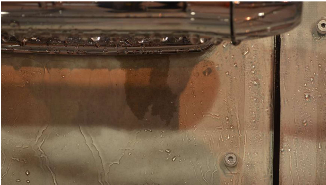
Bild 16. Vagg 1, läckage vid blandarfäste efter start av vattenbegjutning.
