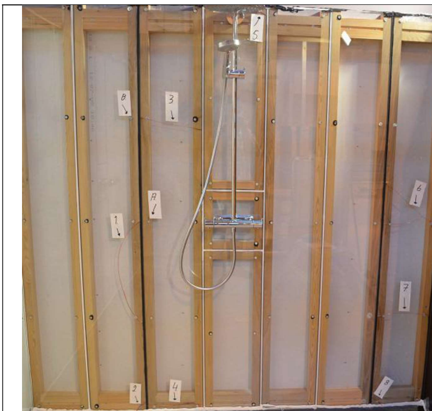
Figur 6 Identifiering av rapporterade skador: No 1-8 Sprickor i glas; A,B Läckage
