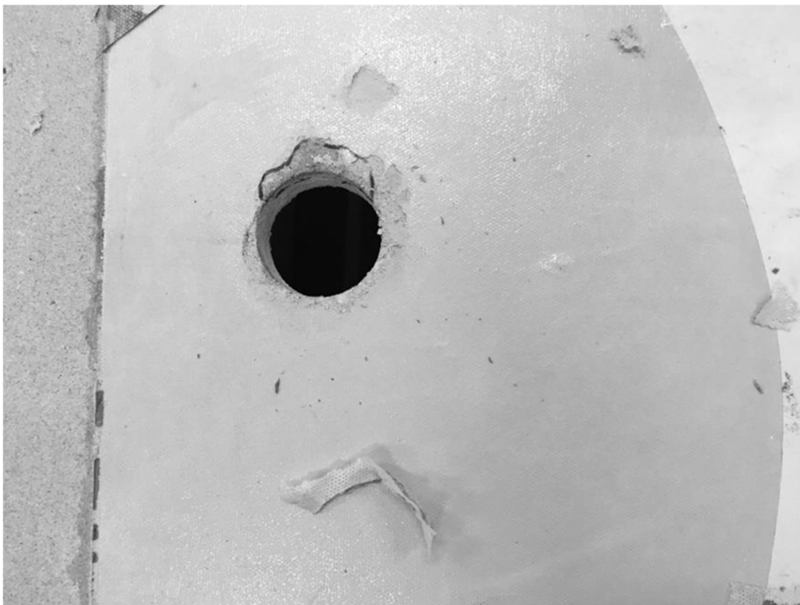
Bild 17. Punkt 14: Mindre läckage vid avloppsröret DN50, längd ca 5 cm, bredd ca 1 cm.
