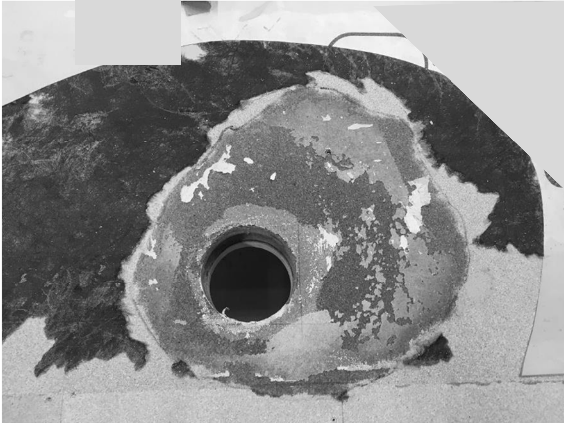
Bild 6. Punkt 13. Stort läckage vid stora avloppsröret, DN110.
