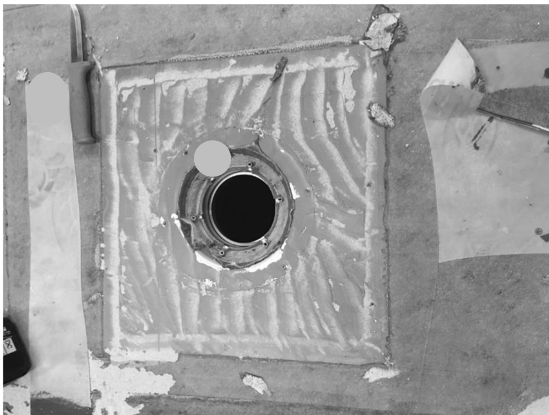
Bild 1. Punkt 17: Ett litet läckage vid hörnet av brunnsmanschetten kring Blücherbrunnen, diameter ca 5 cm.
