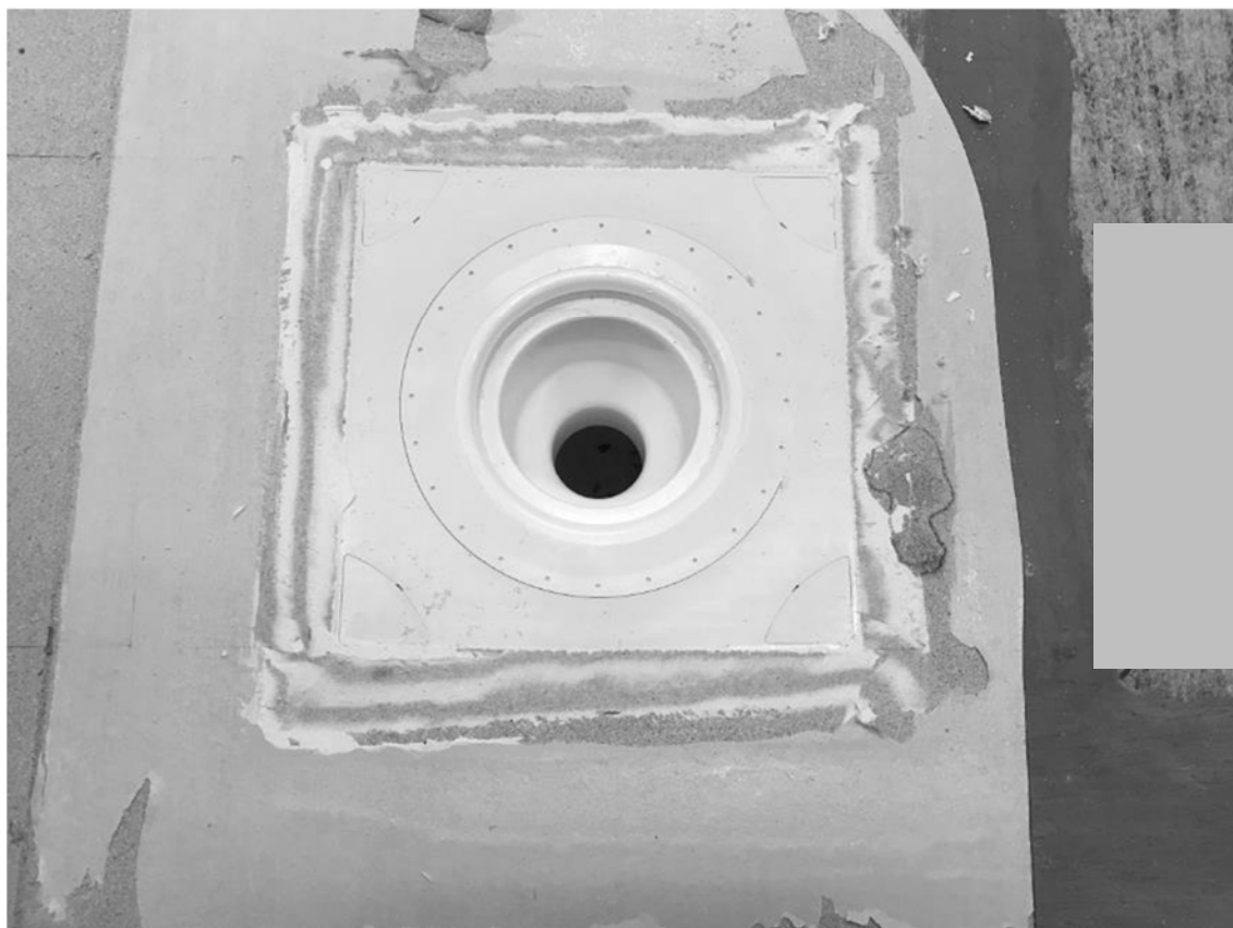
Bild 28. Punkt 15: Läckage kring Purusbrunnen
