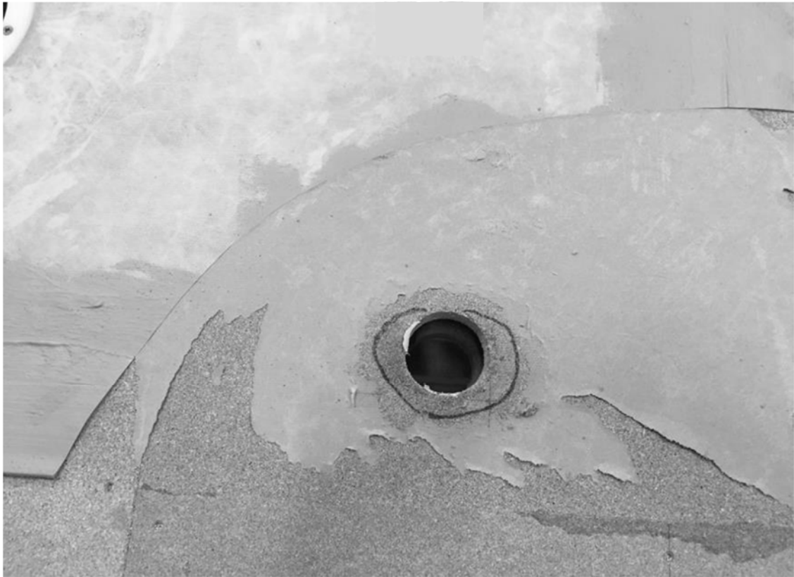
Bild 5. Punkt 14. Lilla avloppsröret, det fanns ett blött parti runt nästan hela röret, bredd ca 1–2 cm.
