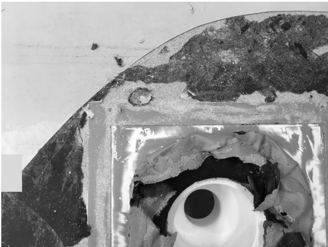
Bild 7. Punkt 15. Mycket litet läckage vid kanten av brunnsmanschetten vid Purusbrunnen
