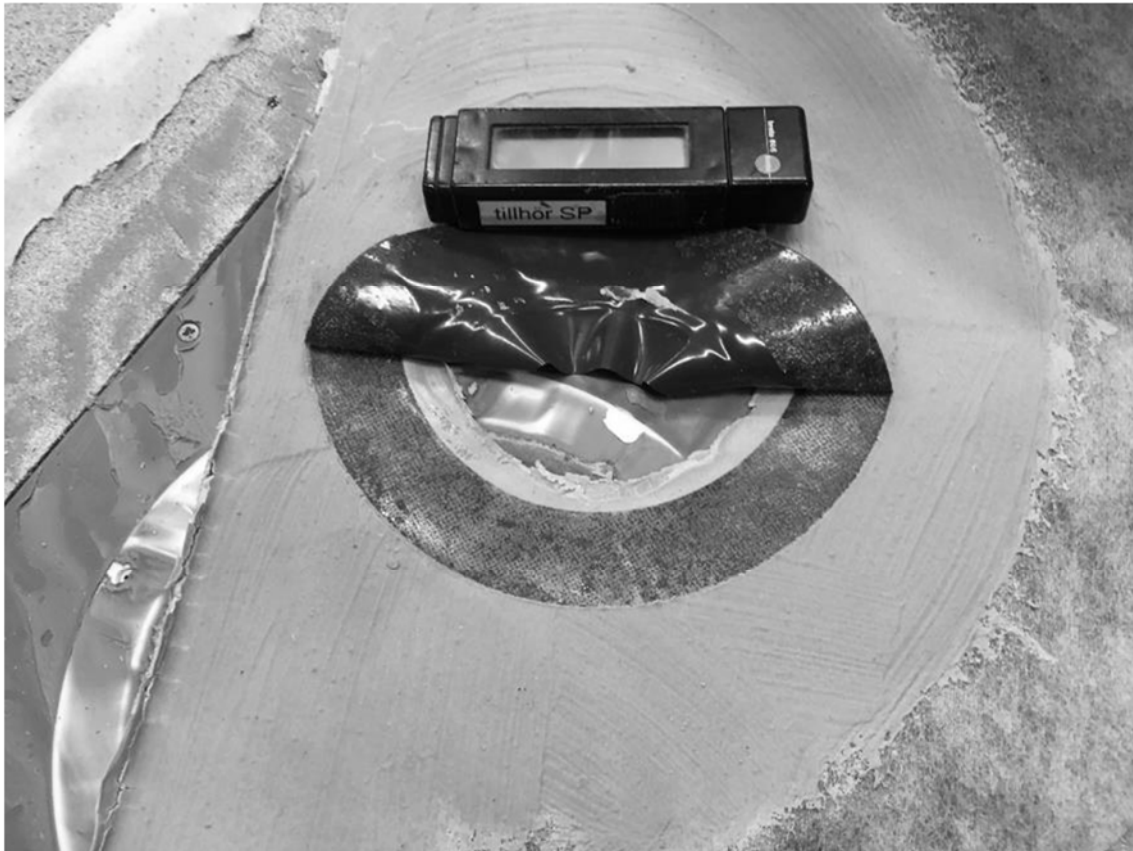
Bild 24. Punkt nr 13: Delaminering hos rörmanschetten vid det stora avloppsröret, DN110
