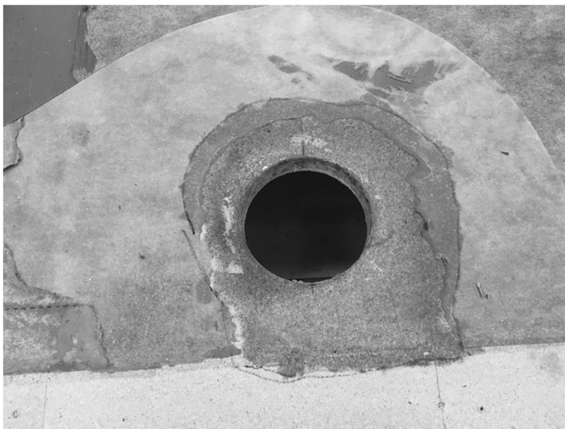
Bild 19. Punkt 13, läckage i kring det stora avloppsröret, DN110.
