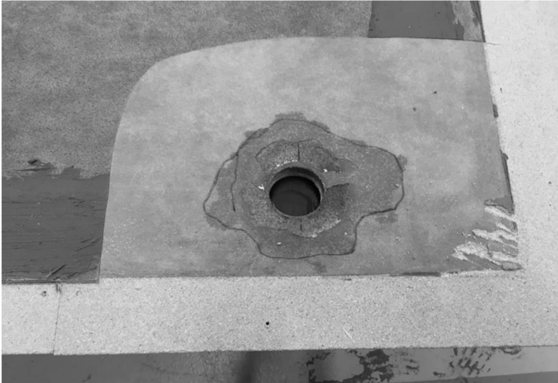
Bild 20. Punkt 14, läckage kring det lilla avloppsröret, DN50.
