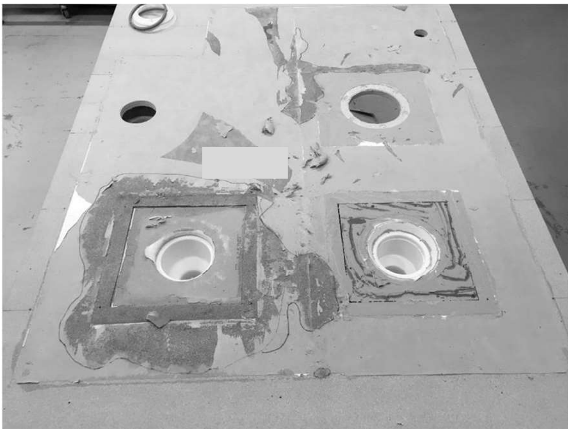
Bild 8. Översiktsbild över hela golvet med läckageställen markerade
