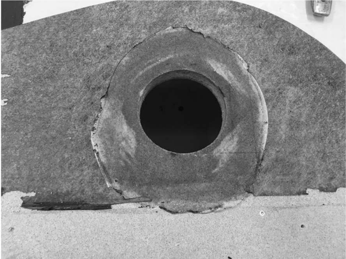
Bild 3. Punkt 13. Läckage vid avloppsröret DN110, bredd 5–7 cm.
