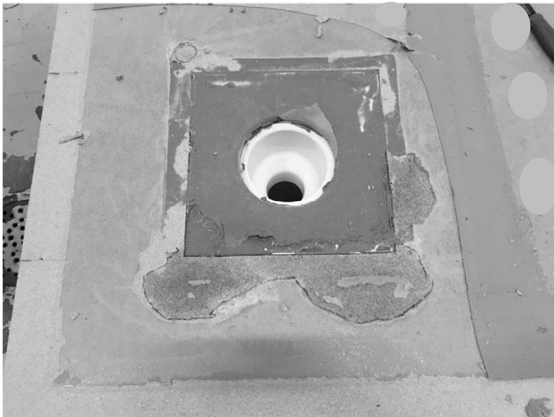
Bild 22. Punkt 15: Läckage kring Purusbrunnen, ca 1/3 av monteringsplattans omkrets, bredd
