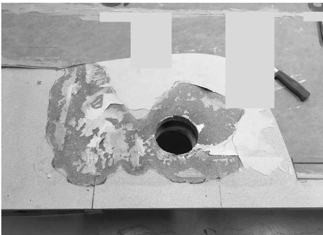
Bild 12. Punkt 2, 3, 4, 5 och 13: Sammanhängande större läckage vid stora avloppsröret samt inner- och ytterhörn, storlek ca 50x 25 cm.
