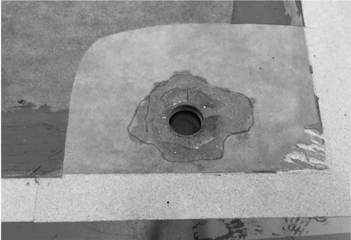
Bild 20. Punkt 14, läckage kring det lilla avloppsröret, DN50.
