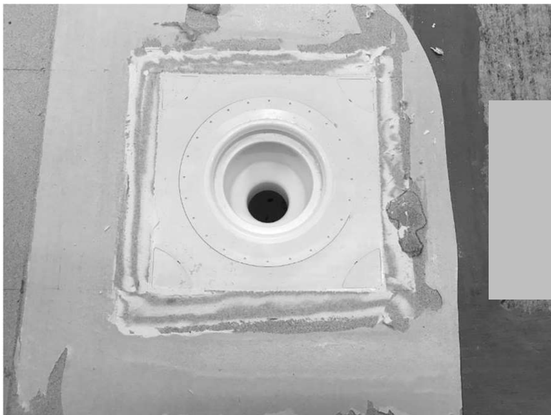
Bild 28. Punkt 15: Läckage kring Purusbrunnen
