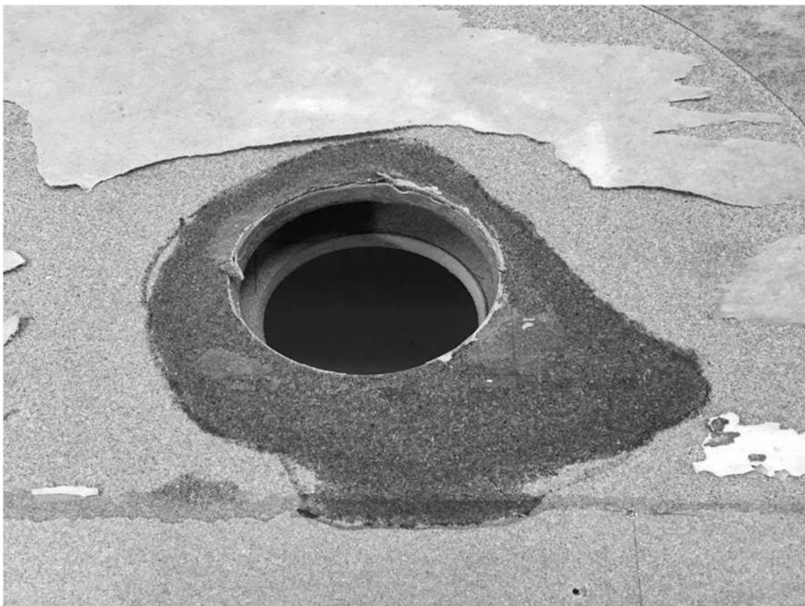
Bild 23. Punkt nr 13: Läckage kring det stora avloppsröret, DN110, bredd 2–10 cm.
