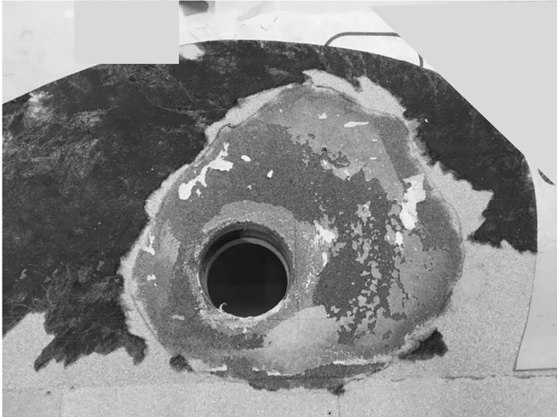
Bild 6. Punkt 13. Stort läckage vid stora avloppsröret, DN110.
