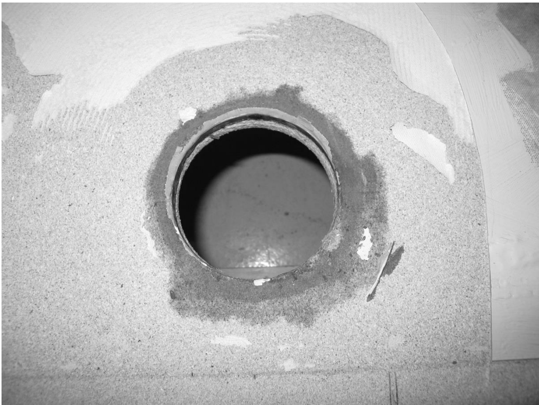
Bild 30. Punkt 13. Läckage kring stora avloppsröret.
