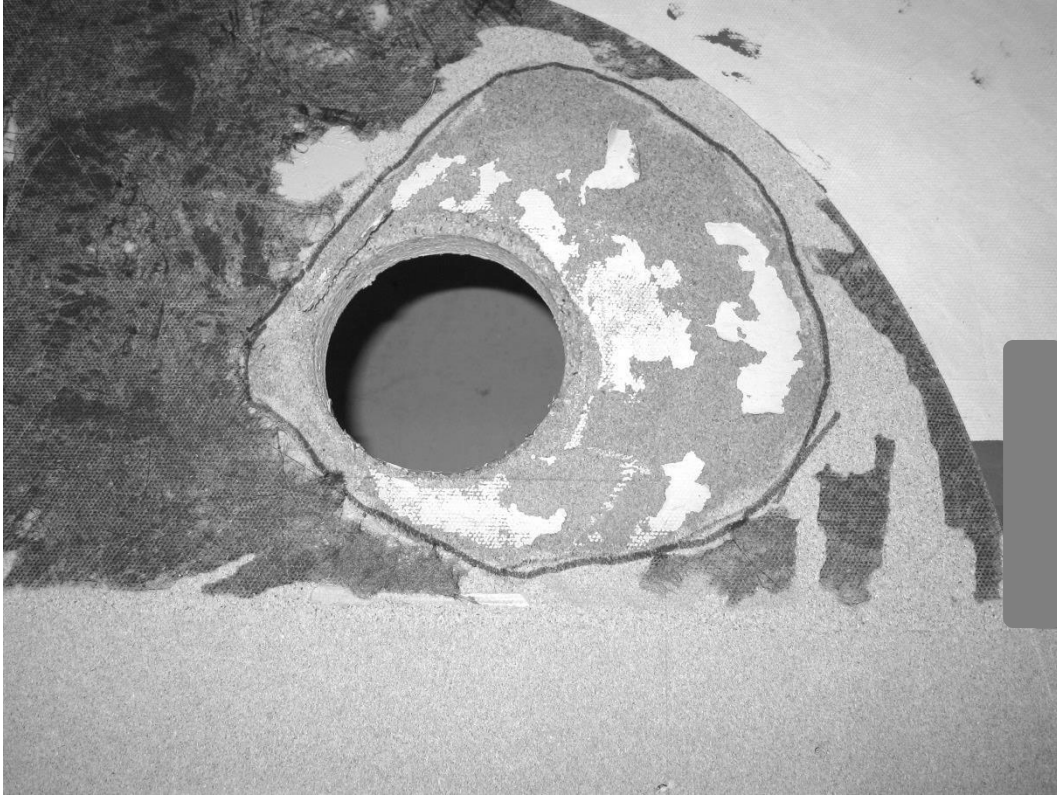
Bild 7. Punkt 13, läckage vid stora avloppsröret, DN110.
