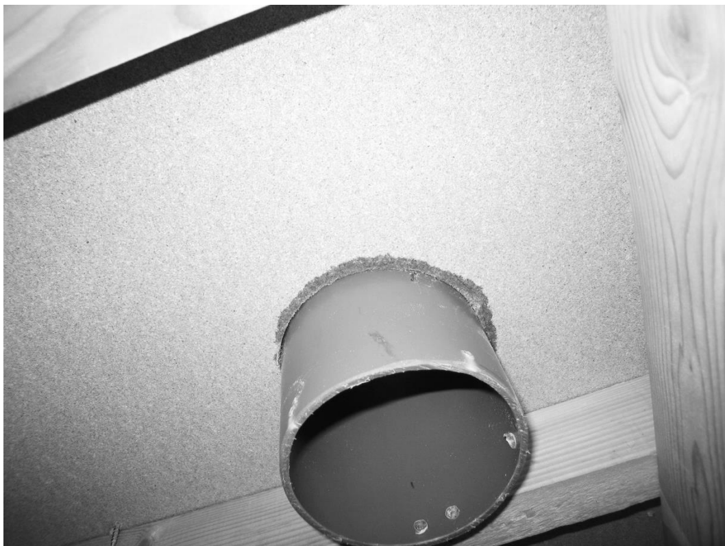
Bild 15. Blött parti kring stora avloppsröret, DN110, bredd 2-7 cm. Från undersidan av provlådan
