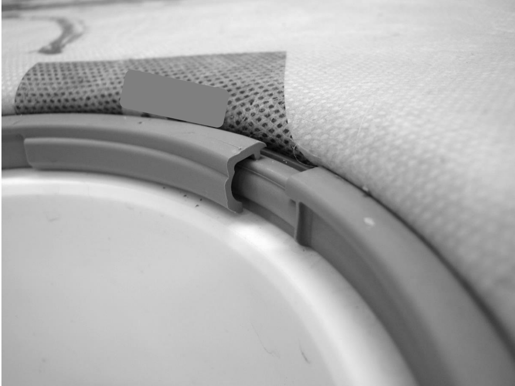
Bild 9. Klämring vid Purusbrunnen före rivningen, falsen har hoppat ut ur spåret där klämringen är delad.
