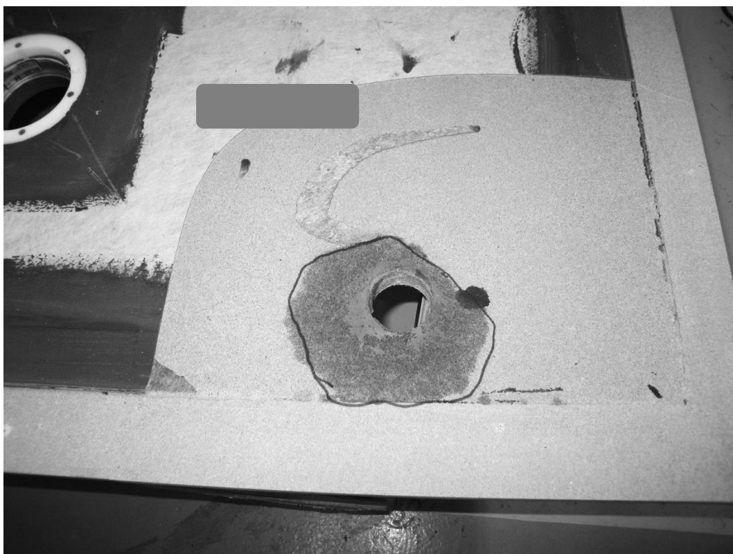
Bild 2. Punkt 14: Blött område kring lilla avloppsröret DN50, bredd 3-7 cm.
