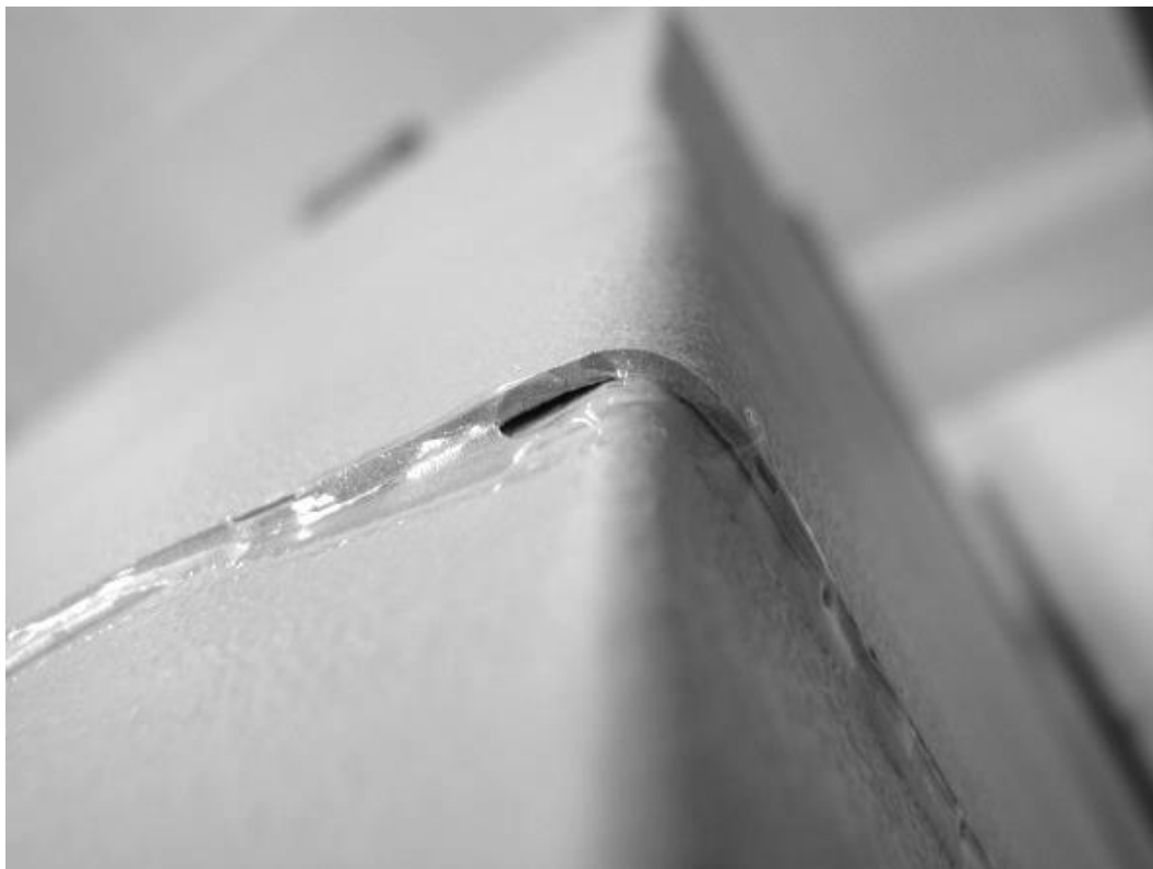
Bild 24. Punkt 5: Spricka i tätningen mellan golv och väggmatta vid ytterhörnet.
