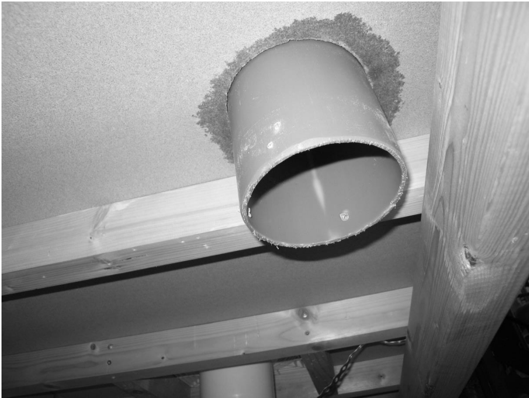
Bild 5. Synligt läckage på undersidan kring stora avloppsröret.
