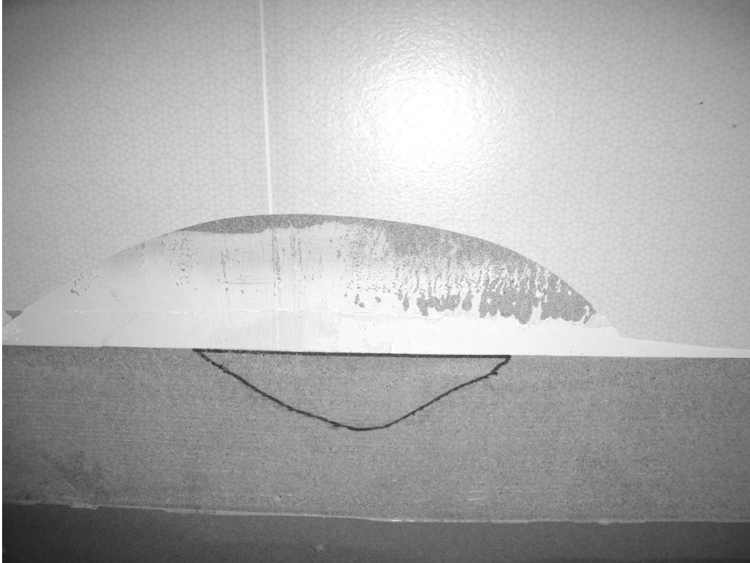
Bild 10. Fuktigt parti på väggen, storlek ca 5*20 cm. Läckaget fanns ca 13 cm upp på väggen där golvmattans uppvik på väggen slutar och mittför väggmattans ändskarv.
