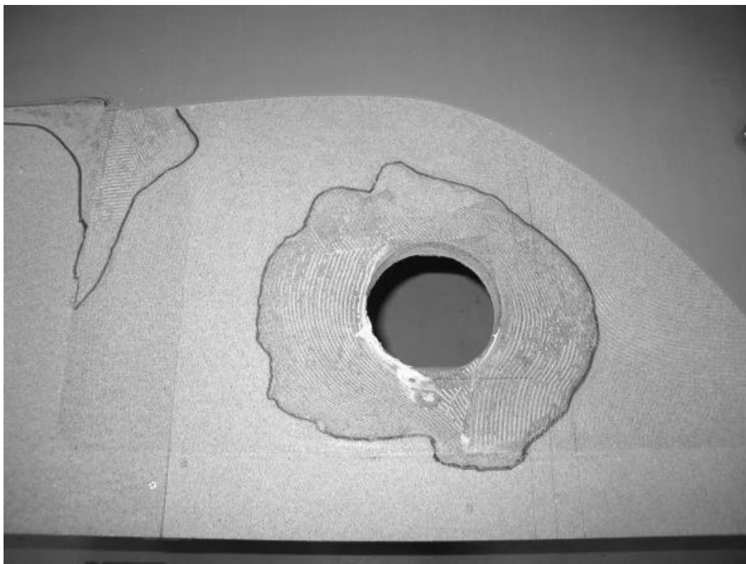
Bild 27. Punkt 13: Det fanns ett blött parti runt hela det stora avloppsröret, bredd ca 10 cm. Till vänster syns läckage på golv vid ytterhörnet.
