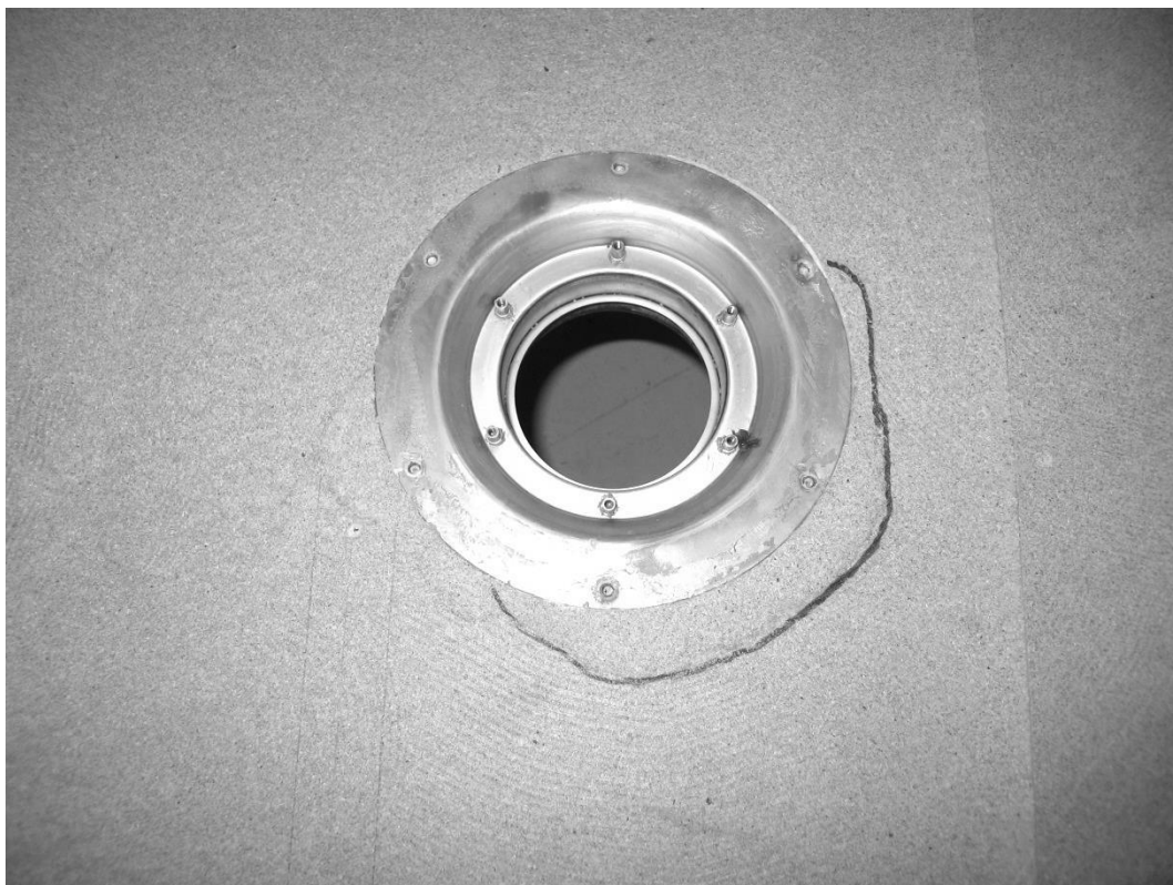
Bild 12. Det fanns ett större fuktigt parti runt ca 1/3 av omkretsen av Blücherbrunnen, storlek ca 3*30 cm. Spånskivan var uppsvälld men området var inte blött utan hade endast lite förhöjd fuktighet. Detta tyder på att läckaget har förekommit under temperaturcyklingen och sedan avstannat under den avslutande vattenbelastningen.
