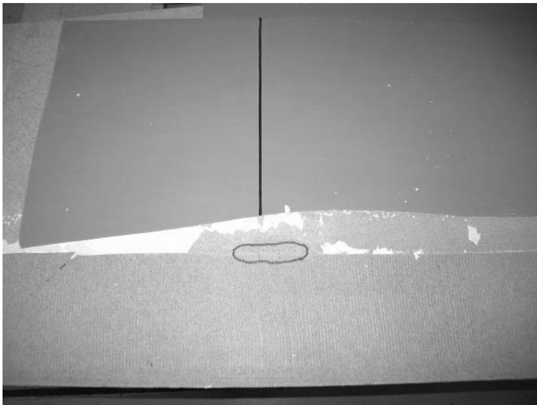
Bild 22. Punkt 2: Det fanns ett fuktigt parti på väggen, storlek ca 2*8 cm. Läckaget fanns ca 13 cm upp på väggen där golvmattans uppvik på väggen slutar och mittför väggmattans ena ändskarv.
