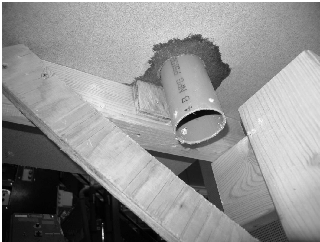
Bild 17. Läckage runt det lilla avloppsröret DN50.
