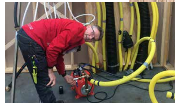
Ulf Frelin Pennonen gjorde en enkel lösning på ett återkommande problem med fuktskador.
