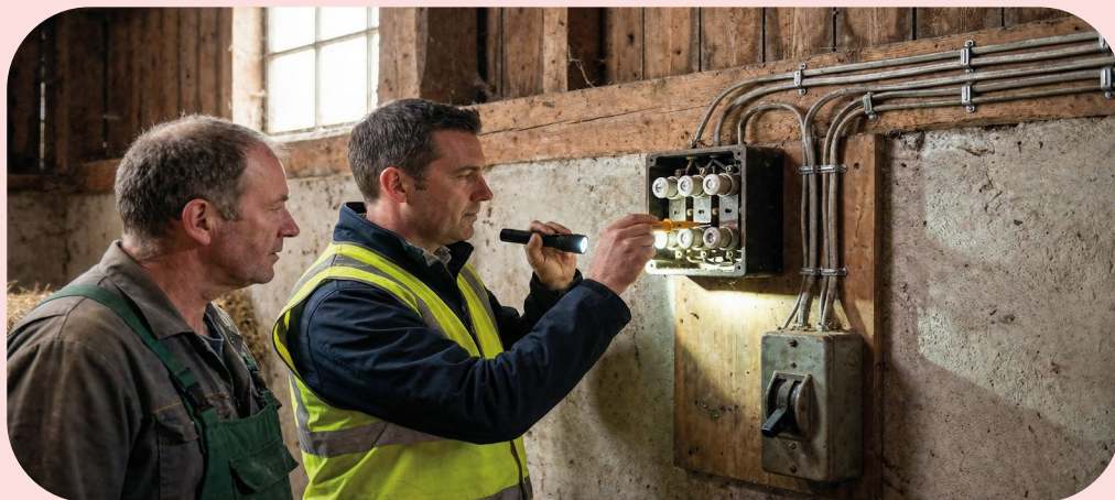
Genom elbesiktningar och krav på brandskydd hjälpte vi länets lantbrukare att säkra sina livsverk mot brandrisker.
